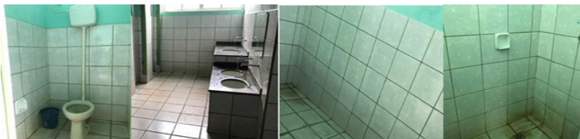
Figura 5 – Áreas internas do banheiro com ausência de barra de apoio
